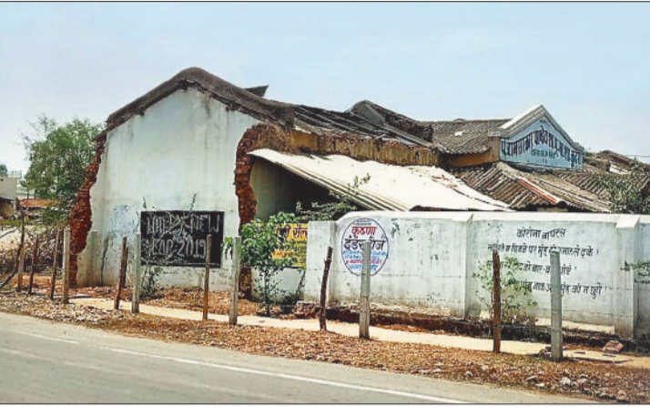
पुराना जर्जर भवन।
